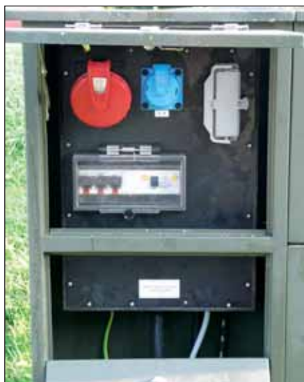
Elektranen von GIFAS-ELECTRIC „Überflur“- dieses Jahr erstmals von der Tiroler Skiliftgesellschaft Jungholz in Anspruch genommen. Dabei werden die Elektranen in Metallkästen integriert Fotos: GIFAS-ELECTRIC
